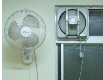
隔離空間不能密不通風，若空氣流通不足，可考慮加裝抽風機。
